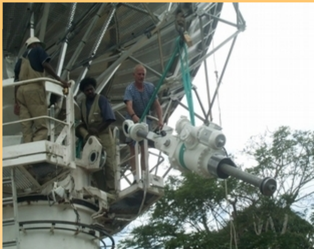
Antenne ALCATEL au Vanuatu
